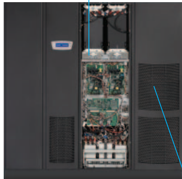
Wartung der Eaton 9395 550 kVA bei laufendem Betrieb
